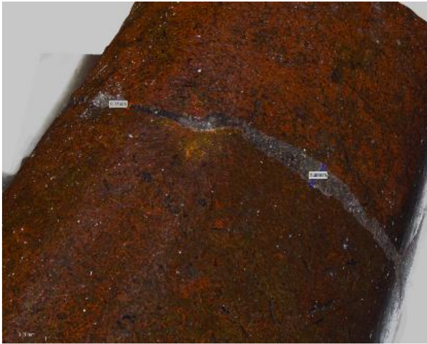
2306261227-Cristo brazo dch-fisura-medidas 3D-2.tif
