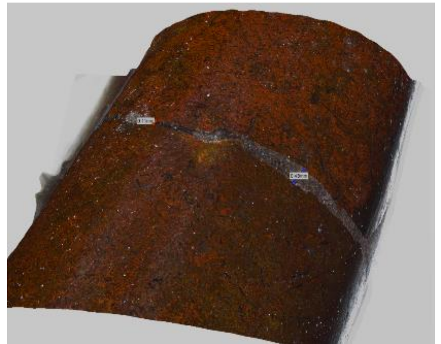
2306261227-Cristo brazo dch-fisura-medidas 3D.tif
